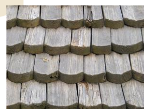
Bild 42: Dokumentation av skadorna
